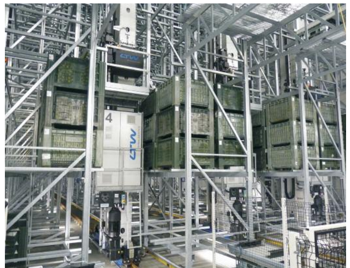
Eingangsbereich des automatischen Hochregallagers bei Mivor. Projekt-Generalunternehmer war LTW aus Österreich
