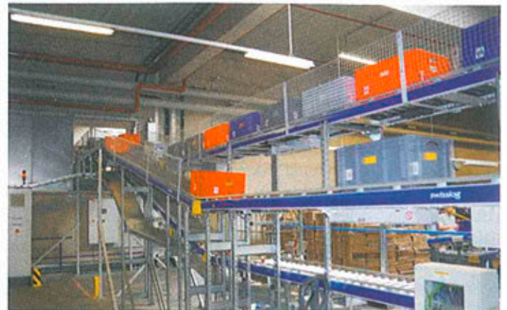
Die unterschiedlichen Teile des Fossil-Logistikzentrums sind durch eine durchgängige Förderanlage miteinander verbunden
