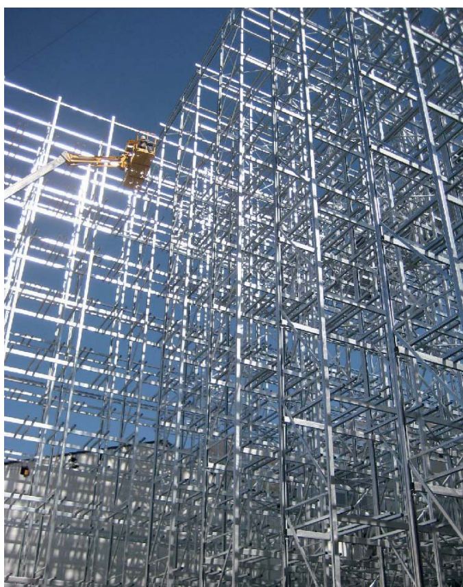
Das 6-gassige HRL hat eine Höhe von 26 m und bietet Platz für etwa 18 500 Großkisten
