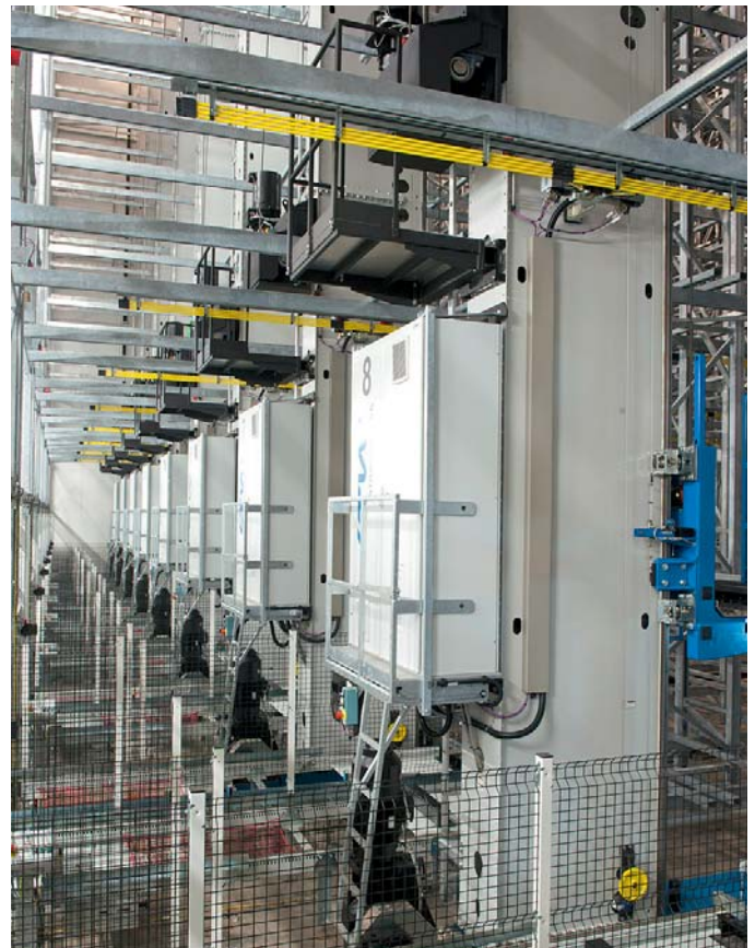
Die Vorzone Nord ist mit einer Anbindung an die Sortierung ausgestattet sowie mit zwei Einfach- Verschiebewagen
